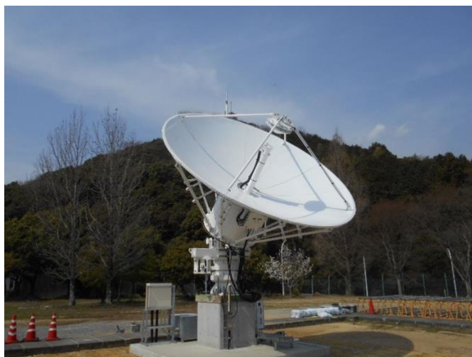
スカパーJSAT 山口ネットワーク管制センター(1号)
